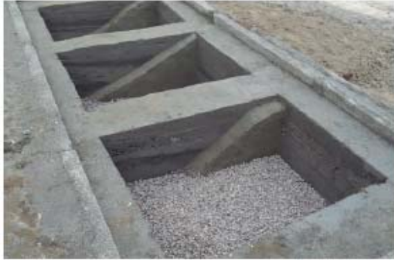
Fosos del paso canadiense en donde se aprecian pasos para la salida de los anfibios y evitar la mortalidad asociada a esta infraestructura.
