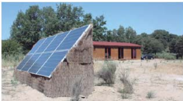
Central de energía solar, muy recomendable para fincas aisladas.
